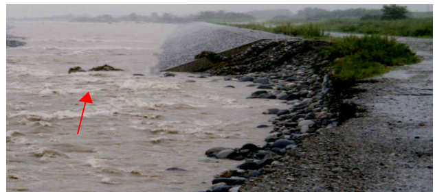
図 5.2 河岸の侵食状況 (H10 洪水)
