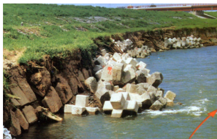
図 5.1 洗掘による被害 (護岸の浮き上がり)
