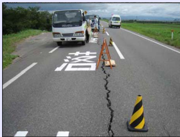
中越沖地震による堤防上面亀裂 (信濃川大河津分水路)
