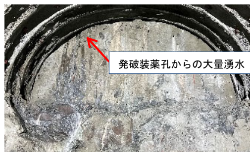
写真-8 大量湧水発生 2 回目 切羽 (179m)
