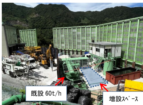
写真-5 濁水処理設備 (60t/h)
