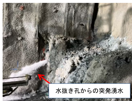
写真-6 水抜き削孔時 突発湧水発生状況
