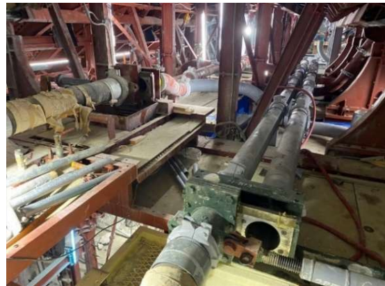
写真 5 配管切り替え装置(2 本×2 系統)
