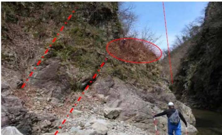
開口節理による岩塊崩落により生じた斜面中腹の緩斜面
