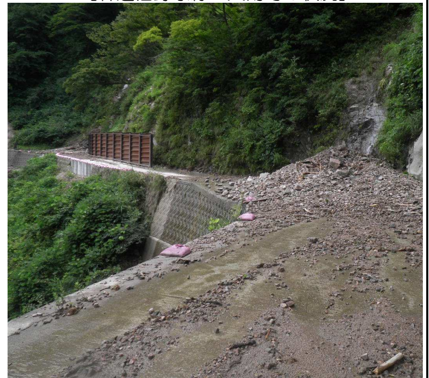
【林道仙野原線 大雨時の状況】
