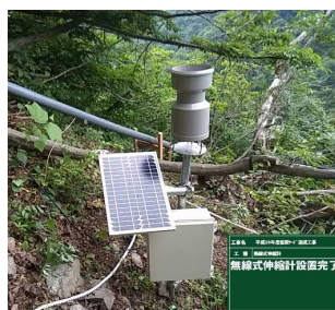
【写真④】雨量計設置
