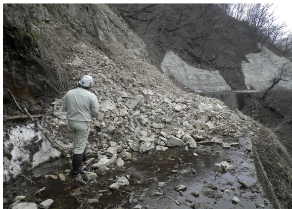
崩土により通行止（林道仙野原線）
