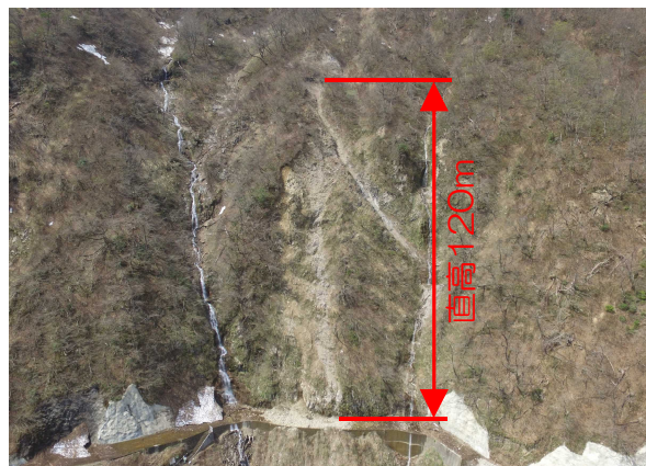
法面の崩落（直高約120m）
