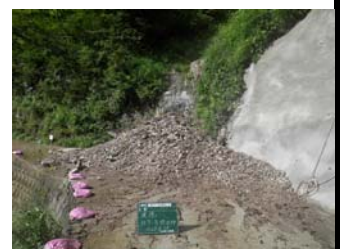
【写真-11 崩土発生状況】
