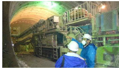
▲トンネル掘削部の吹付モルタル状況を視察する田中市長(右)と窪田部長(左)
