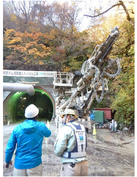
▲前田建設工業株監理技術者(右)よりトンネル工事の説明を聞く田中市長(左)
