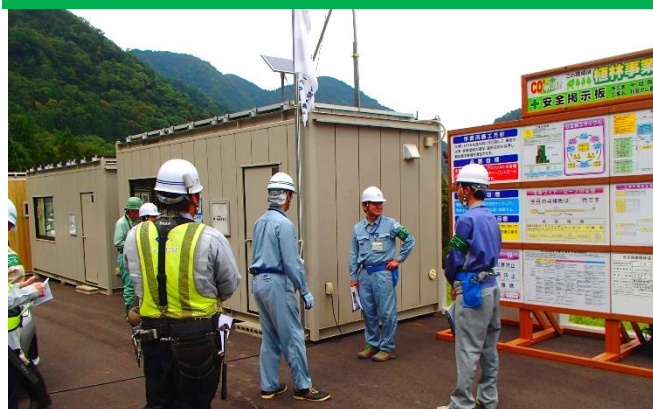
写真②:ハイブリッド型休憩施設(屋根上は太陽光パネル)
