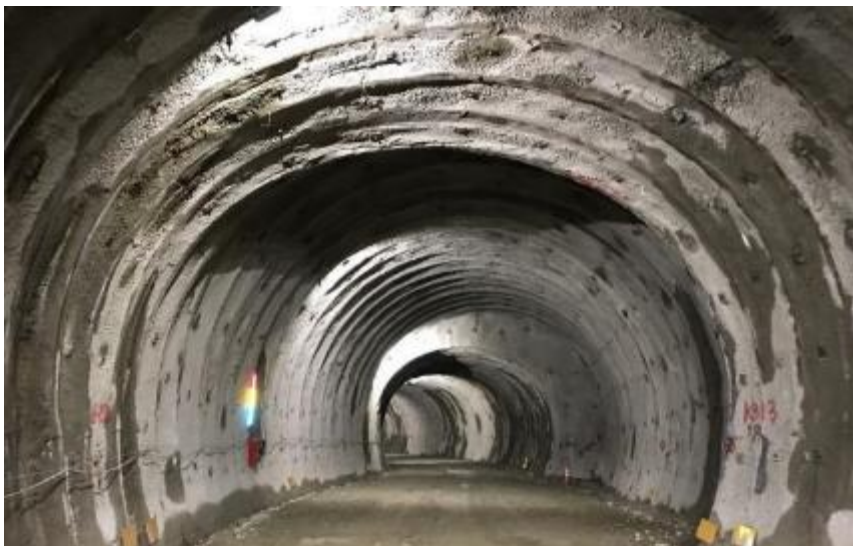
河床進入トンネル坑内 (拡幅部) (林道連絡トンネルから200m付近 終点側を望む)
