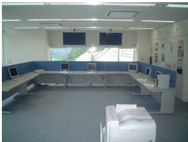
自動制御装置（他ダム事例）
