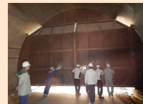
湯川トンネル閉塞
