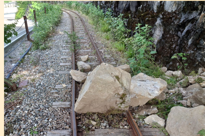
落石により損傷したトロッコの軌条(線路)
