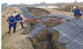
東日本大震災(H23.3)での被災調査状況
