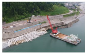
防災対策(国道8号 糸魚川市市振地先)
