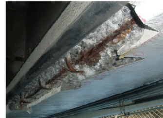
主桁の損傷状況(青海川橋)
