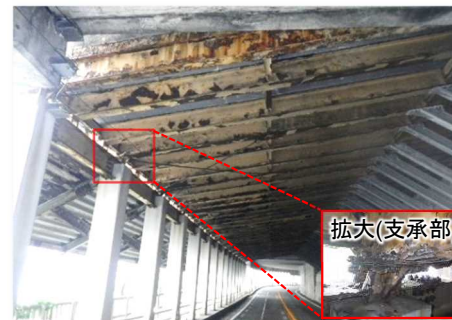
塩害による洞門鋼製部材の腐食
