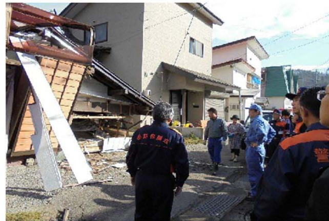
被災現場視察の状況 【白馬村内】
