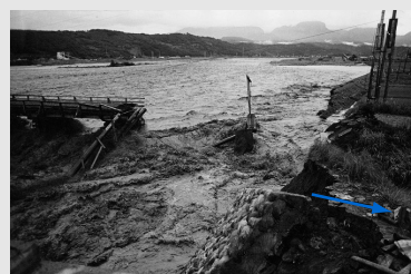
落橋した今井橋 ▲昭和 44 年 8 月洪水の被害状況
