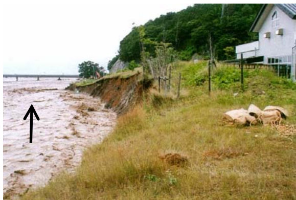
堤防決壊状況（糸魚川市大野地区）
