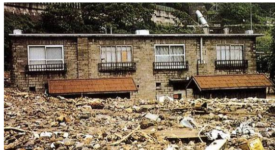
土砂流出により1階部分が埋まった住宅 （小谷村光明下）
