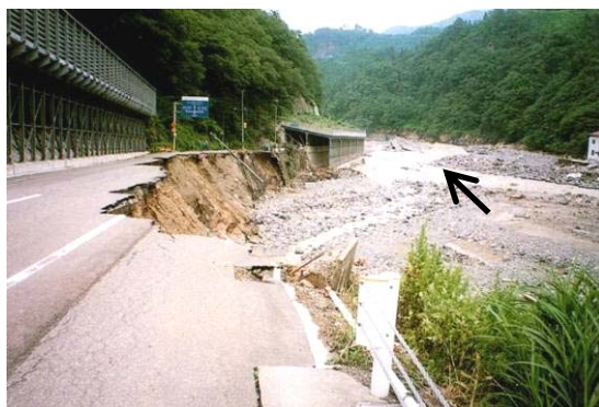
国道148号線被災状況（糸魚川市平岩地先）
