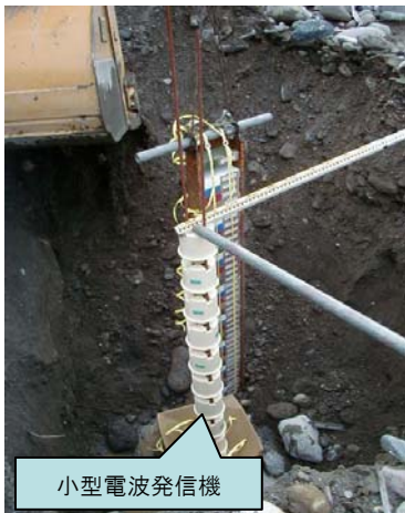
洗掘センサー等の設置状況
