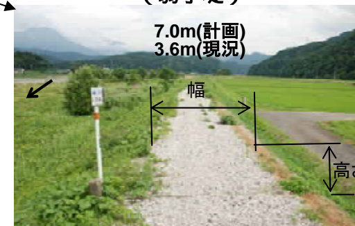
堤防断面不足(弱小堤)の現状(左岸5.4k) 計画断面に対して、幅、高さが不足
