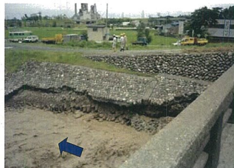
局所洗掘による護岸基礎部の被災状況 (糸魚川市上刈地先：平成7年7月洪水)
