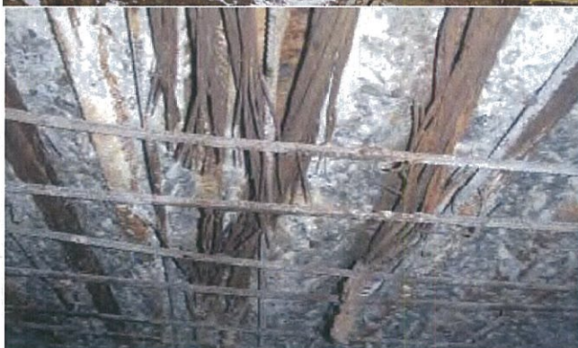
老朽化による PCケーブル腐食破断状況
