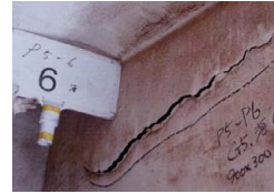
弁天大橋(コンクリート剥離)
