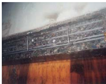
橋梁内部の鋼材破断状況
