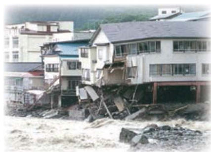
小谷村姫川温泉 （宿泊施設被害状況）
