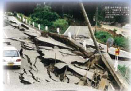
糸魚川市平岩（道路被害状況）
