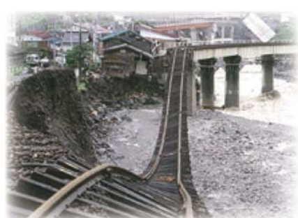
糸魚川市平岩（JR 大糸線被害状況）
