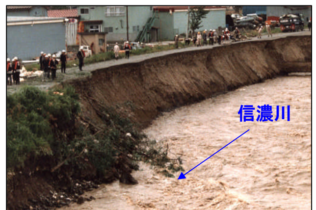
十日町高島地先での堤防欠壊状況
