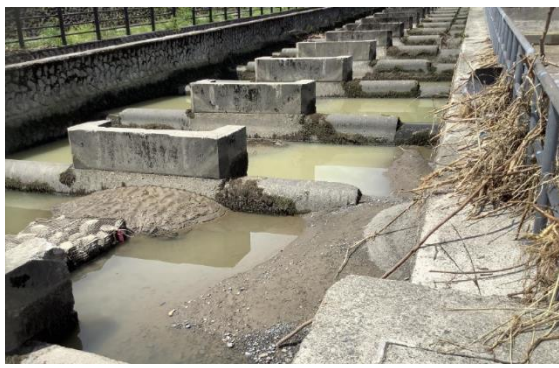
中規模出水後の魚道土砂堆積
