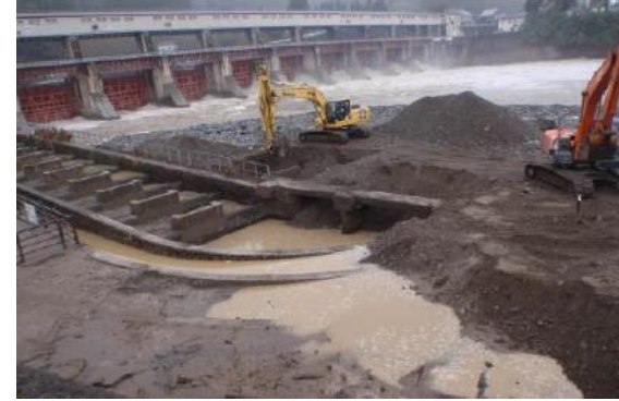
中規模出水後の魚道土砂堆積
