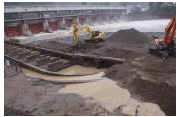
中規模出水後の魚道土砂堆積
