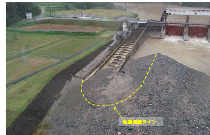
図1.2 魚道の土砂堆積状況全景（2019年10月15日）
