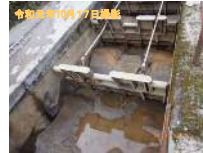
○土砂堆積状況
