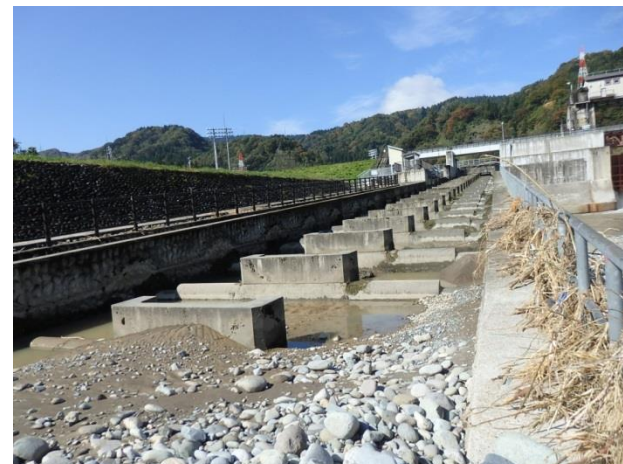
魚道折返し部上流方の被災状況
