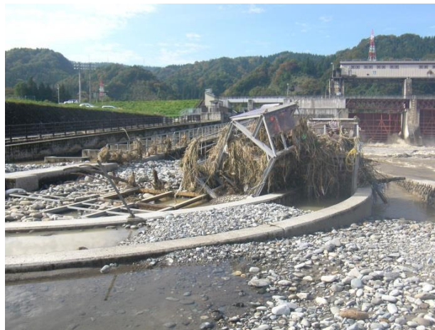
サケ遡上調査用トラップの被災状況
