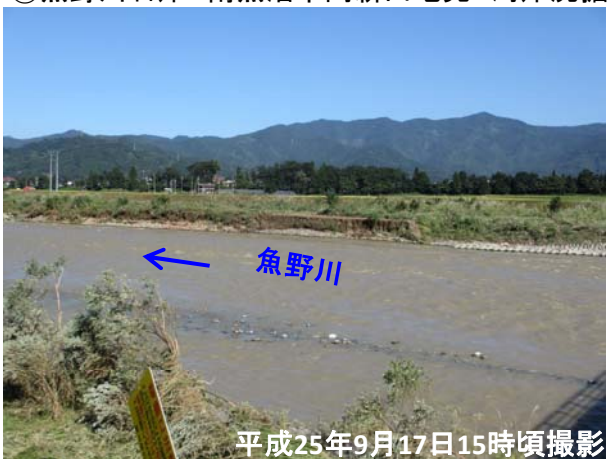
③魚野川右岸 南魚沼市岡新田地先 河岸洗掘
