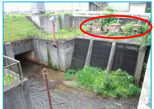
湯殿川排水ポンプ設備 3台
