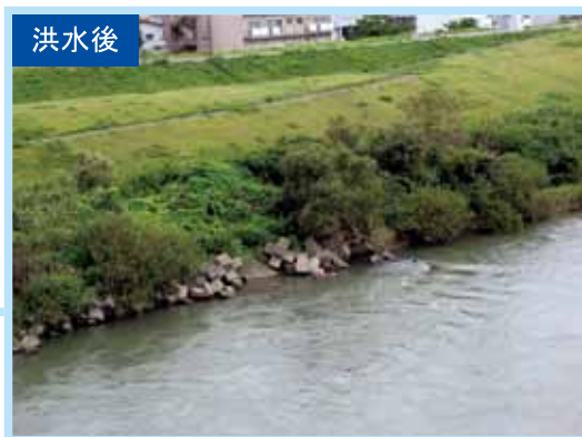
根固めブロックが流出
