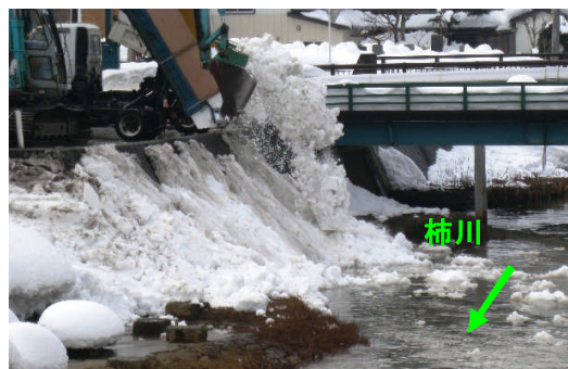
排雪状況(拡大:常盤橋)(2月14日)
