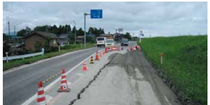
堤防居住地側小段の亀裂と液状化による噴砂跡
