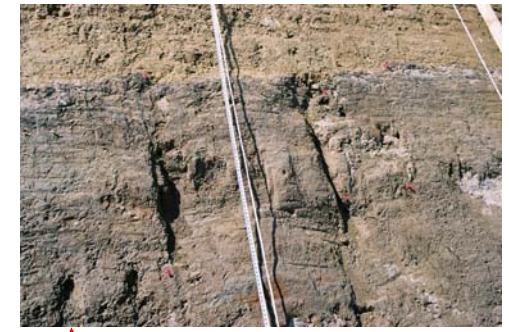
小段頭部に数箇所認められる亀裂
