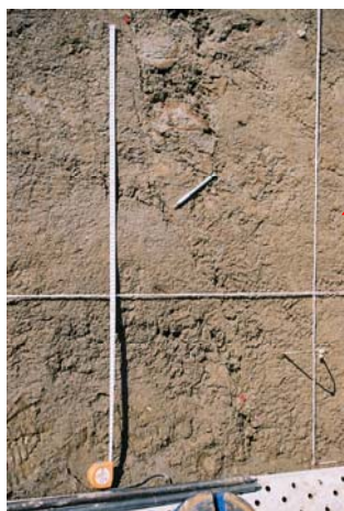
堤体下部の亀裂
