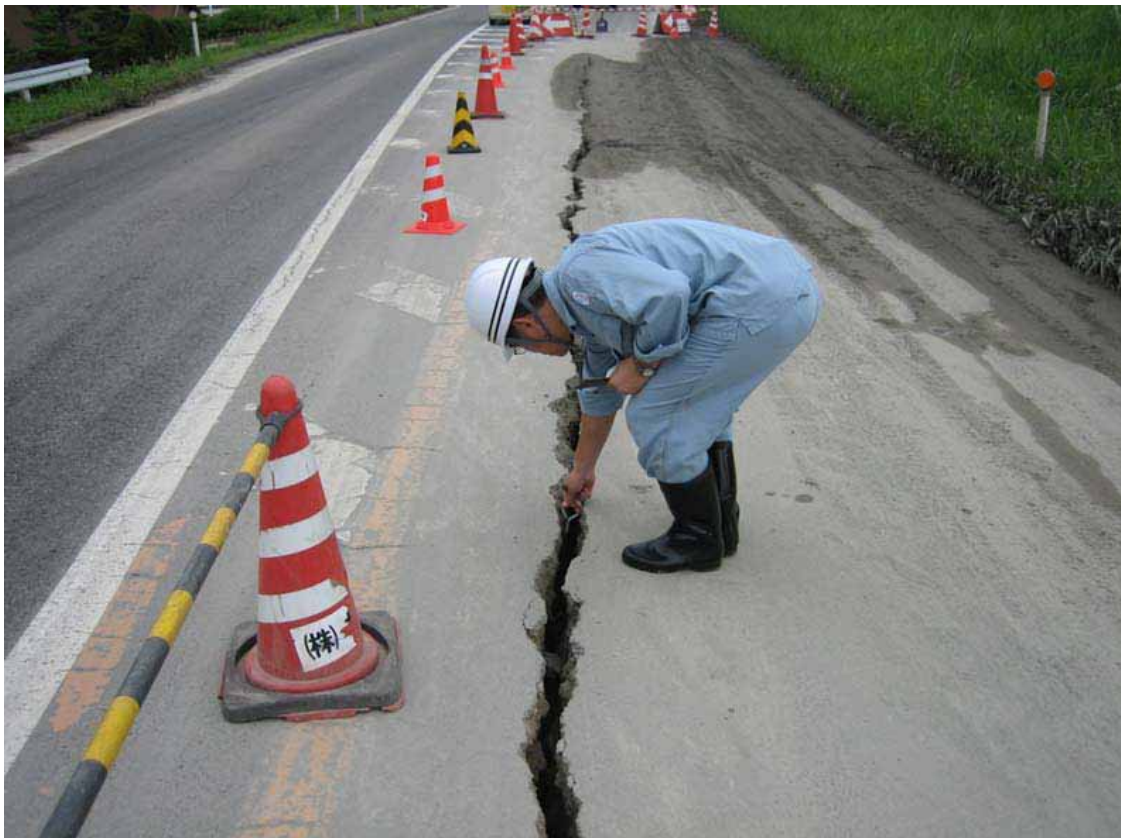
【堤防の亀裂(堤防上の道路)】
