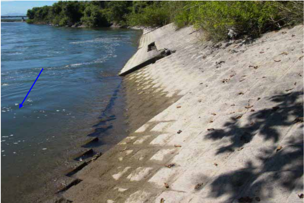
【損壊した護岸】
