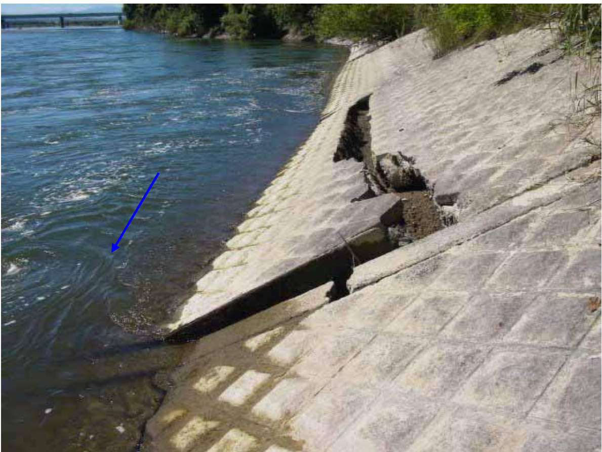
【損壊した護岸】
