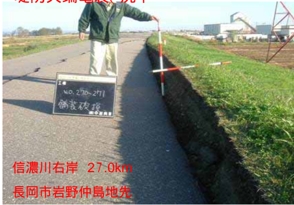
堤防天端亀裂、沈下
