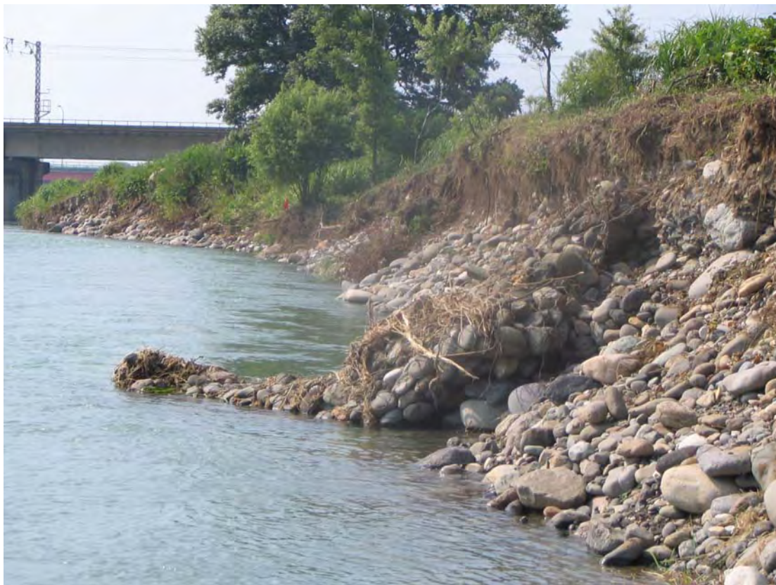
糸魚川市寺島地先【護岸の欠壊】
