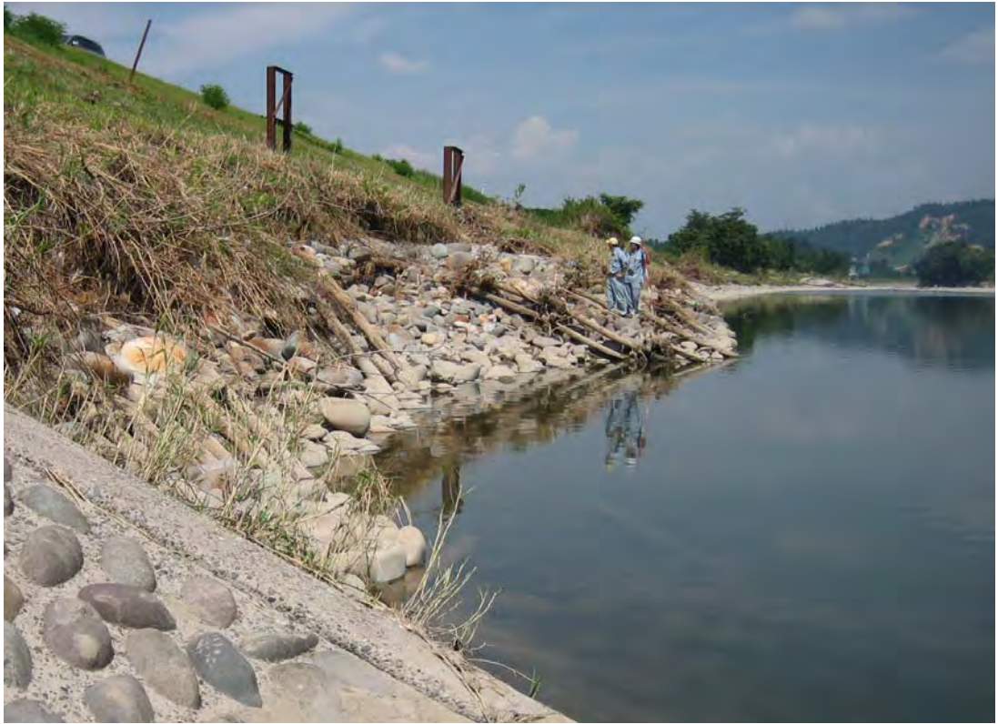
小千谷市真人地先【護岸の欠壊】
