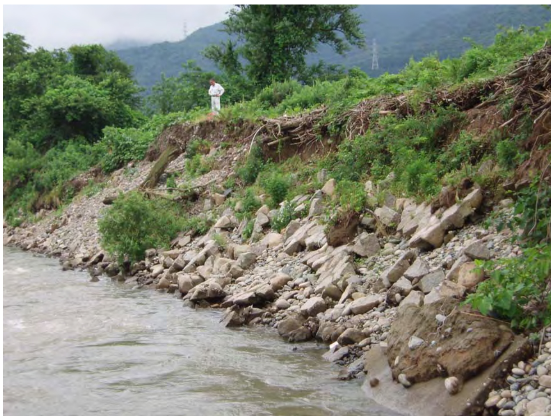
五泉市小流地先【根固工流失・護岸の欠壊】
