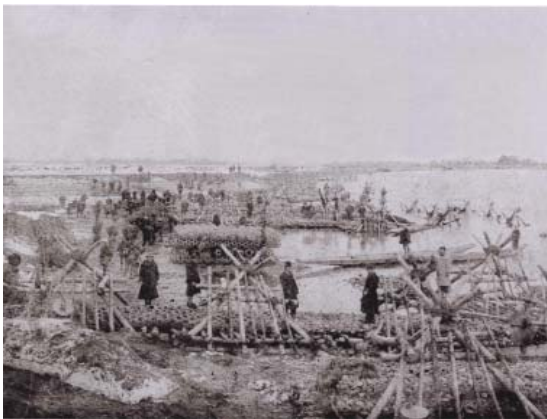
自在堰陥没における仮締切工事と推測される写真 燕市皆川氏寄贈
