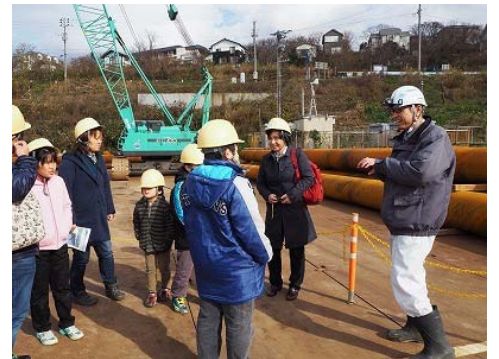
現場見学では工事を担当されている（株）安藤ハザマの八島所長から工事の内容などを説明していただき、直接現場の方とお話しできる貴重な機会でした。
