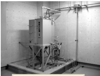
燃料小出し槽
