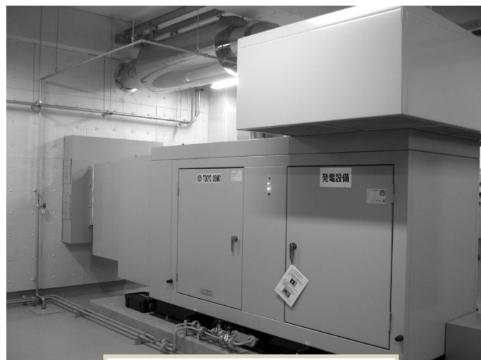
250KVA予備発電装置
