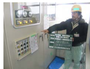
操作禁止札設置確認
