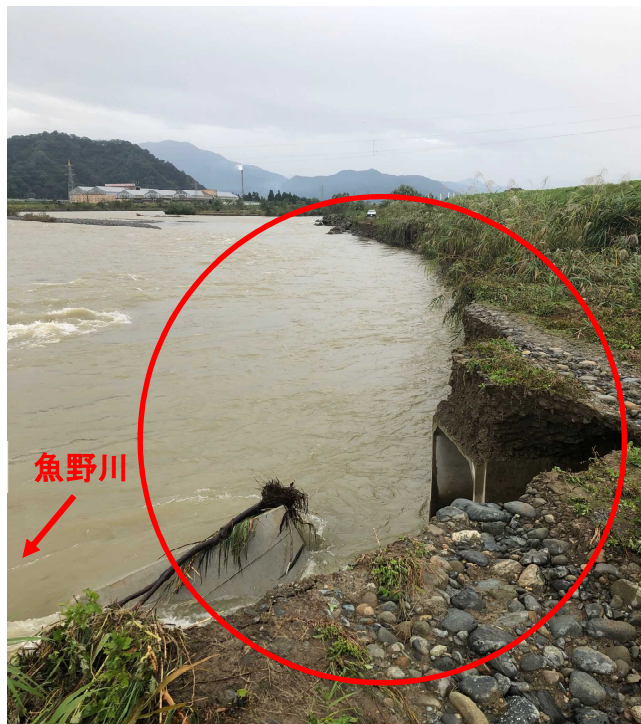
堤防欠損状況
