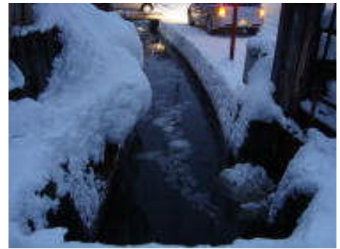
消流雪用水ポンプ稼働状態（H24.2.1）
