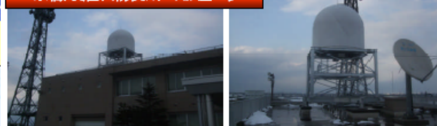
水橋局〔富山防災ステーション屋上〕
