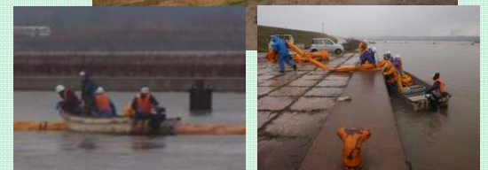
洗堰上流に設置したオイルフェンス 本川へ流出すると船を使用した大規模な作業となります
