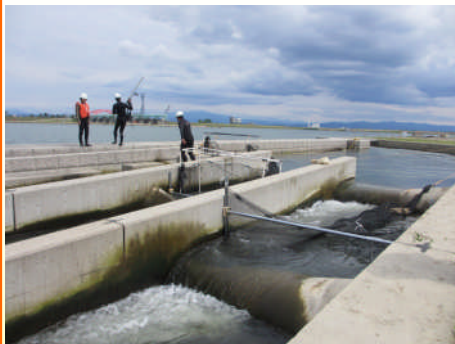
魚道上部に捕獲網を設置
