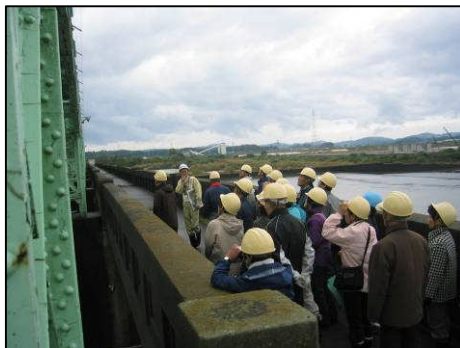
現在の可動堰で老朽化の状況を説明している様子。
