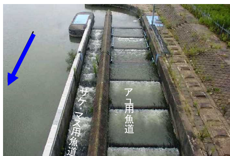
蒲原大堰に設置された魚道
