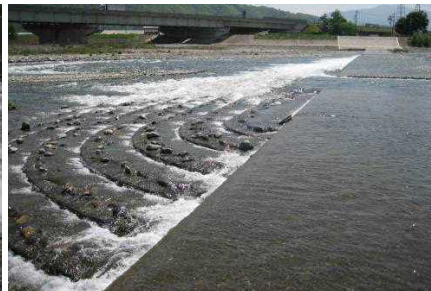
勘左衛門堰（犀川）の魚道
