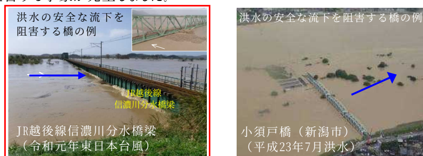
写真 8 改築が必要な横断工作物の例
