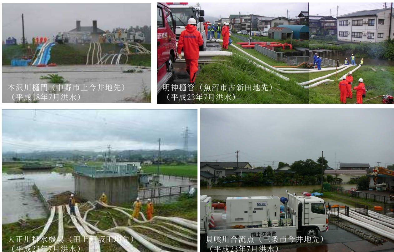
写真 9 内水被害発生と対策の実施状況
