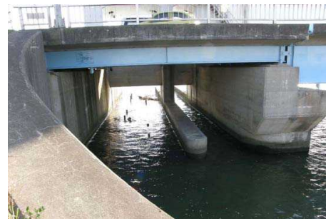
信濃川水門に設置された魚道
