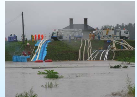
排水ポンプ車による内水対応
